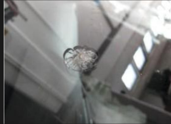
PRIEŠ REMONTO DARBUS
